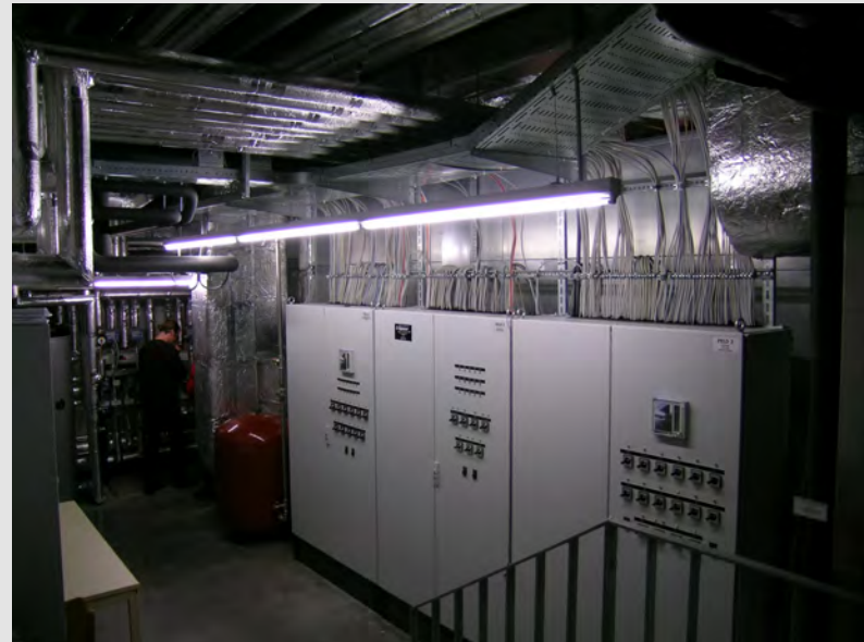
La complessità impiantistica data dall'integrazione con la cabina inverter Fotovoltaico di copertura nel Gemeindezentrum di Ludesh (AUT) Prog. Arch. H. Kaufmann anni 2005_2006.
