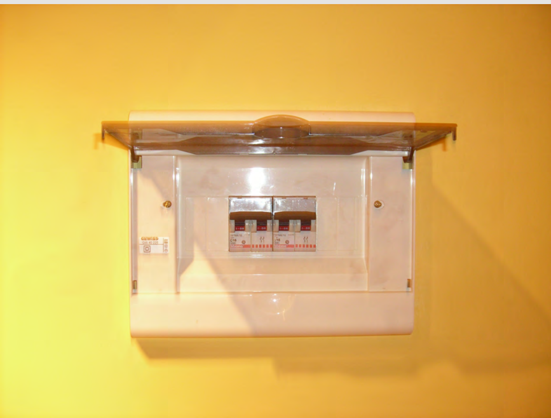
Quadro elettrico principale
