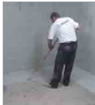
Fig. 8.6a - Fasi di realizzazione di una rifodera interna realizzata con MAPELASTIC FOUNDATION sulle pareti verticali e MAPEPROOF sull'orizzontale: applicazione di MAPELASTIC FOUNDATION sulle pareti verticali e sul nuovo magrone di pulizia per una fascia di 50 cm almeno
