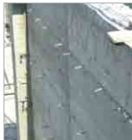
Fig. 7.43 - Lame di cassero sporgenti dalla parete in c.a. prima della rimozione delle stesse
