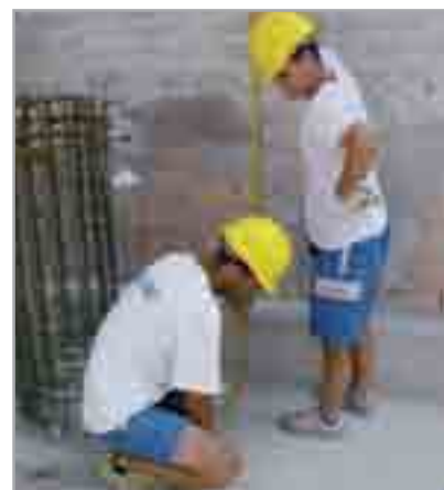
Fig. 7.67 - Misurazioni per definire le dimensioni per il taglio del telo MAPEPROOF, che dovrà partire da almeno 1 m dall'attuale fondo scavo
