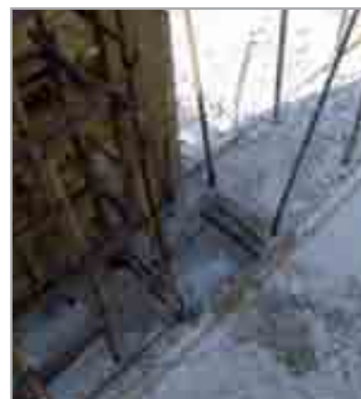
Fig. 7.56b - Demolizione per una profondità di circa 15 cm della parte superiore della platea
