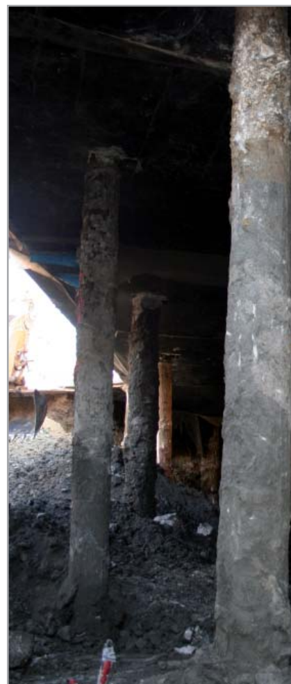
Fig. 4.5 - Esempio di costruzione in Top Down. Scavo eseguito al di sotto della soletta in calcestruzzo armato gettata precedentemente
