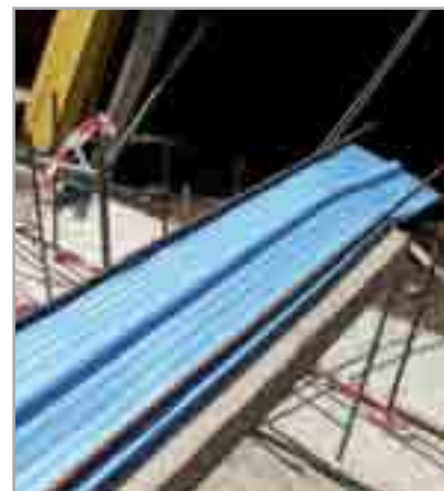
Fig. 7.56a - Esempio di posa di IDROSTOP PVC BI nella mezzera della parete nel caso in cui il waterstop non sia stato preventivamente ammorso nel getto: fissaggio mediante filo metallico di due tondini di ferro alle estremità del waterstop
