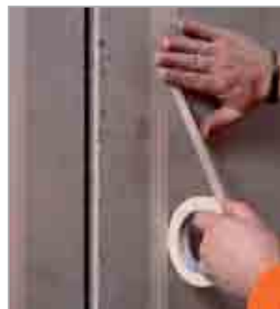
Fig. 7.48a - Fasi dell'impermeabilizzazione elastica di un giunto di dilatazione, soggetto a movimenti fino a 10 mm, con MAPEBAND TPE: per evitare sbavature laterali dell'adesivo epossidico, stendere del nastro di carta ai lati del giunto
