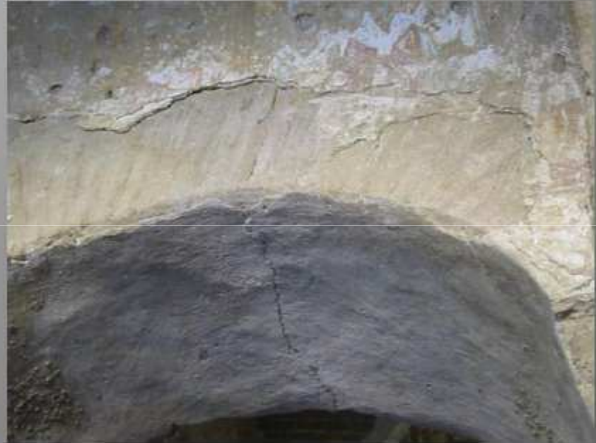
Antalya, Chiesa di S. Nicola, particolare di una fessura intradossale in chiave.
