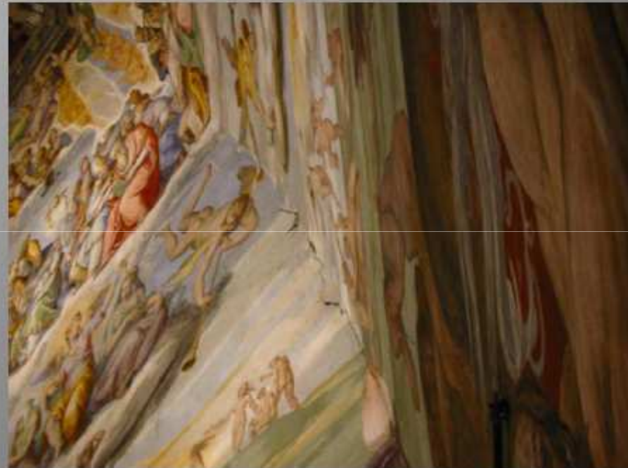
Firenze, Santa Maria del Fiore, particolare di lesioni sulla cupola
