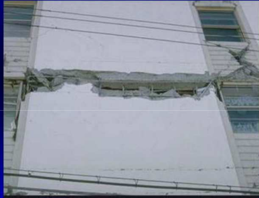
Rottura per Scorrimento
