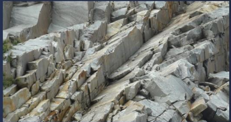
Fratturazione dell'ammasso roccioso
